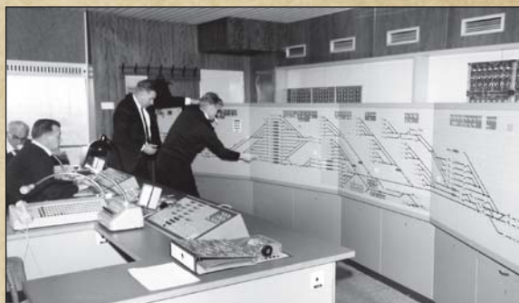
Das Stellwerk Hamm-Rangierbahnhof-Ost wurde in den 1960er-Jahren in Betrieb genommen.
