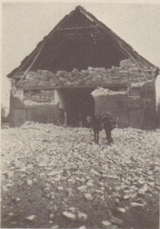
Hof Dasbeck in Hamm-Heessen, vom Sturm zerstörte Giebelwand.
