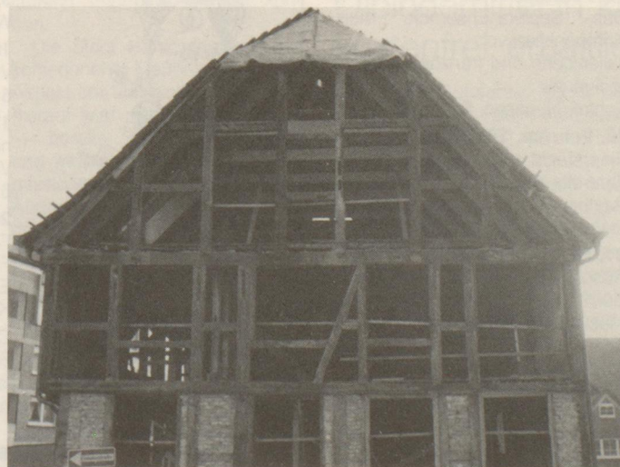
Henin bis auf's Skelett abgemagert. Dies ist jedoch nur ein vorübergehender Zustand.
