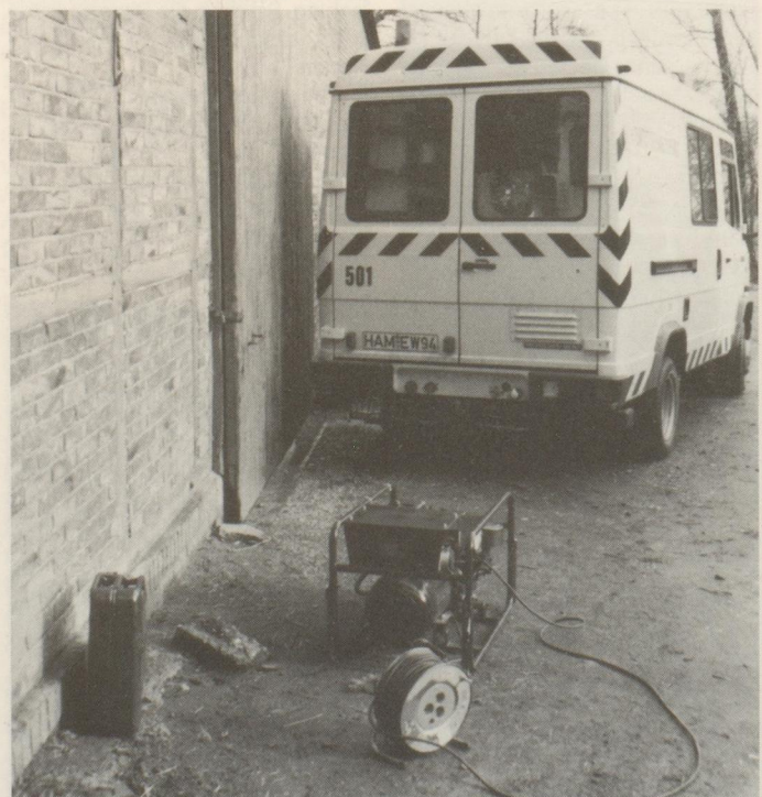
Mit 3,5 kV-Notstromaggregaten konnte kurzzeitig ein Versorgungsengpaß überbrückt werden.
