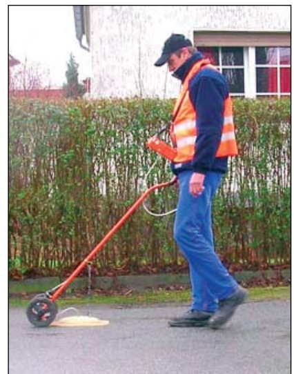
Straßen und Bürgersteige werden regelmäßig auf Gaslecks überprüft.
