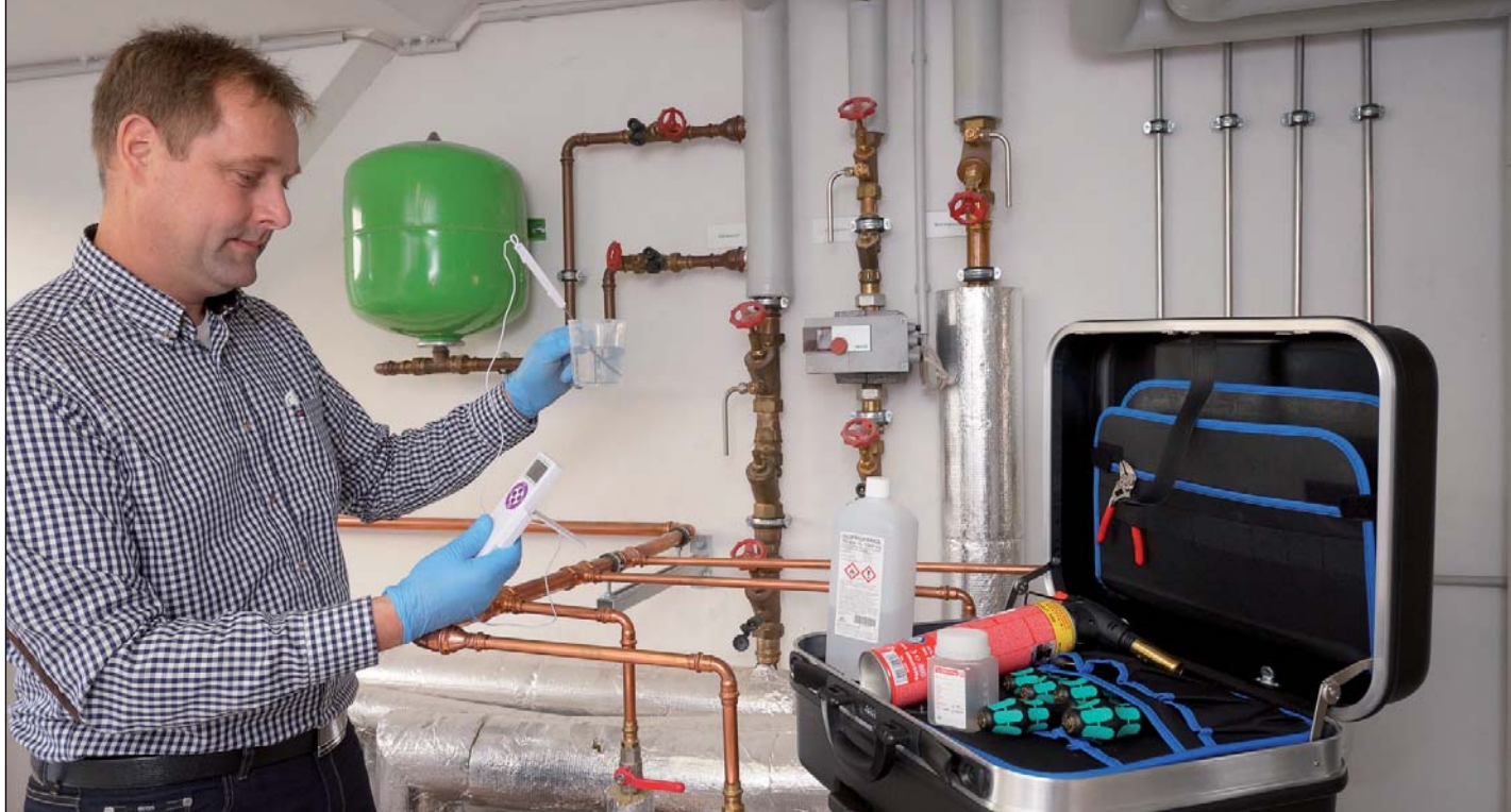
Entnimmt Proben an einer Trinkwasser-Installation: Olaf Schulze Tilling, hierfür zertifizierter Mitarbeiter der Stadtwerke Hamm
