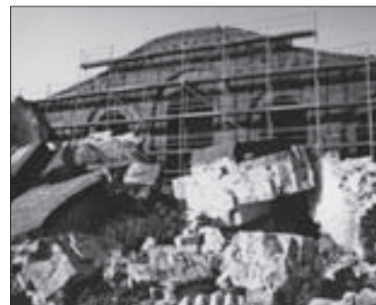
Schuttberge vor der Elektrozentrale.
