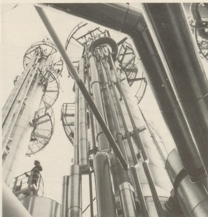
Durch die optische Linse des Fotografen gewinnt die technische Apparatur ästhetische Perspektive: Rohrleitungen in der Kohleumwandlungsanlage Werne-Stockum.
