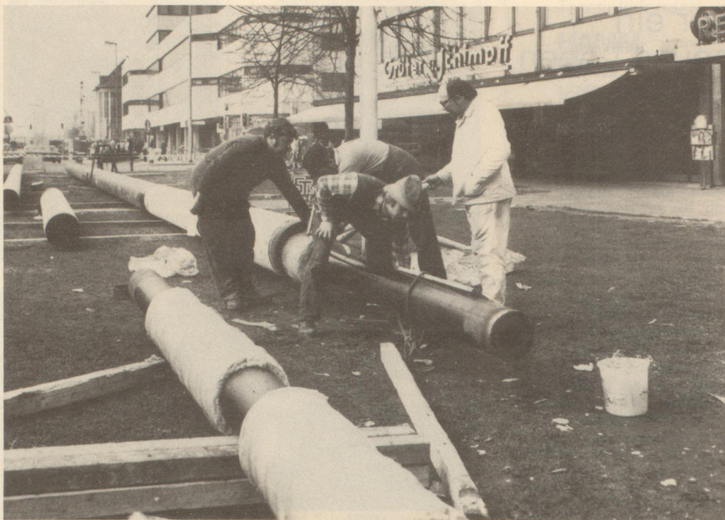
Strom, Gas und Fernwärme werden künftig auch in Hamm den Wärmemarkt bestimmen. Der Ausbau dieser leitungsgebundenen Energien setzt allerdings hohe Investitionen voraus.
