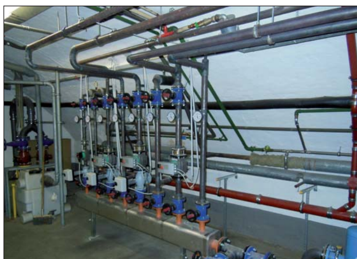
Modernste Technik – die neue Heizzentrale von Schloss Oberwerries
