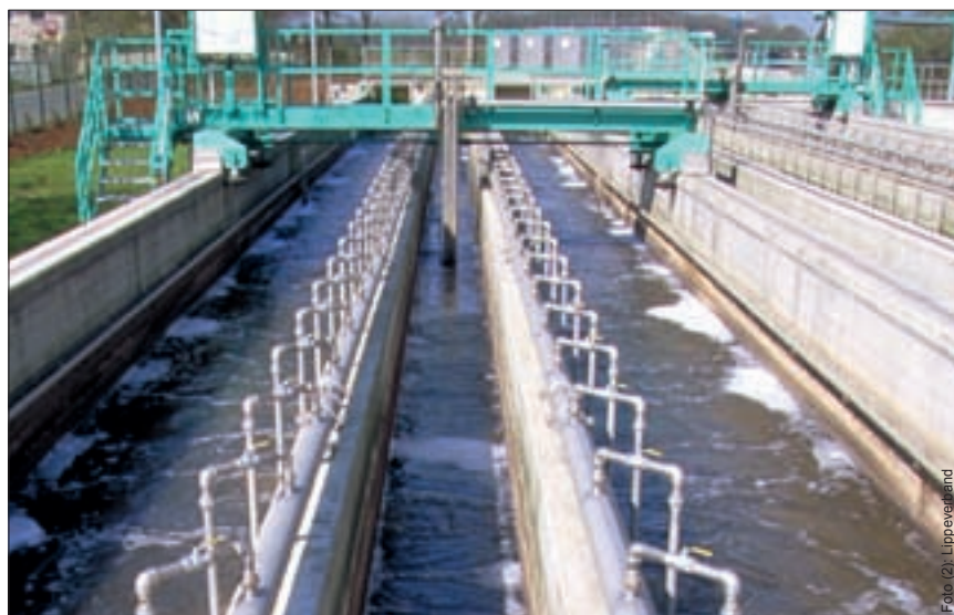
31,5 Millionen Kubikmeter Abwasser müssen jedes Jahr geklärt werden.
