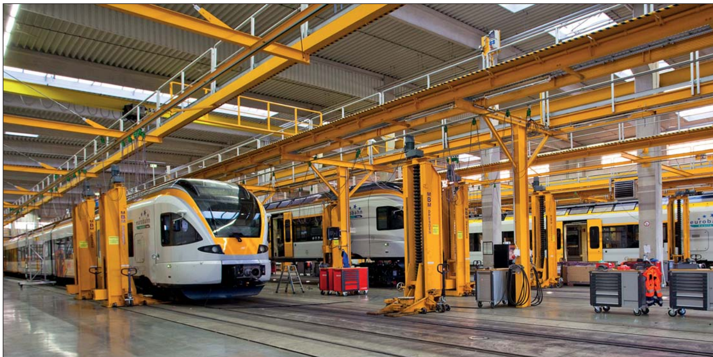
Auf vier Gleisen gleichzeitig können die Eurobahn-Züge in der großen Werkstatthalle in Heessen gewartet und repariert werden.
