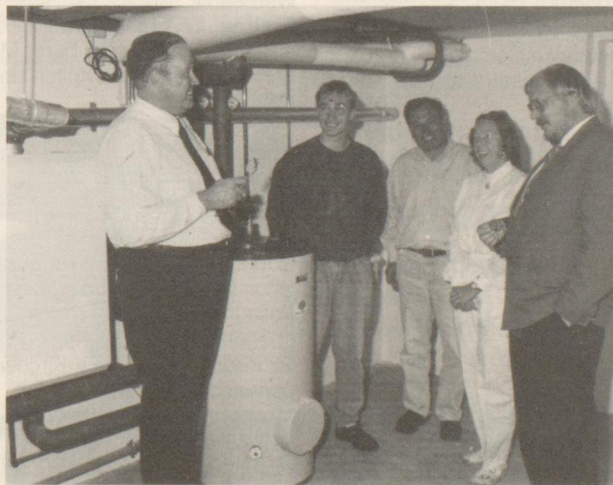
Stolz präsentieren Friedrich Volkenborn (links) und seine Frau (2.v.r.) die neue Brennwertanlage. Mit im Bild: die ausführenden Installateure und Stadtwerke-Kundenberater Stöchel (r.).
